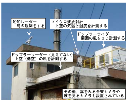
図1. 旧池島ごみ焼却場の屋上にずらりと並んだ計測機器。機器は台風に備えてワイヤーでがっちり固定されている。
